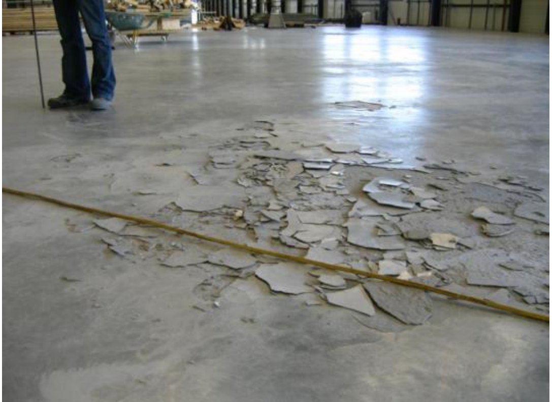
Figuur 7.12 Toplaag is losgekomen van constructieve onderlaag.
